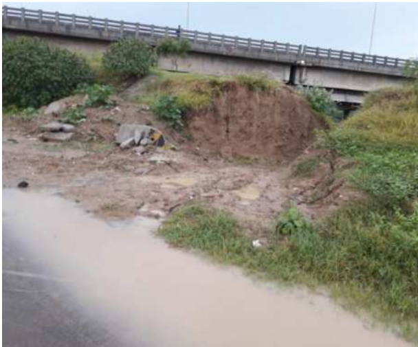
Location : HIGH VULNERABLE AREA – GNAYARU (PASAVANPALAYAM) PULICAT Latitude : 13°15'36.13"N Longitude : 80°12'53.29"E
